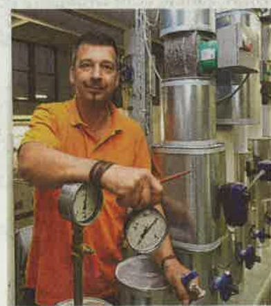
Jens Krautwald kümmert sich unter anderem um die Heizanlage.
